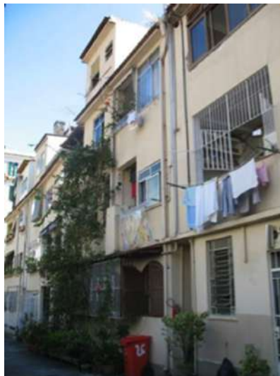
Figura 13 – Descaracterização das fachadas dos fundos de edifício da Praça Mucio Leitão (Setor "B") Fonte: Autores (2010)
