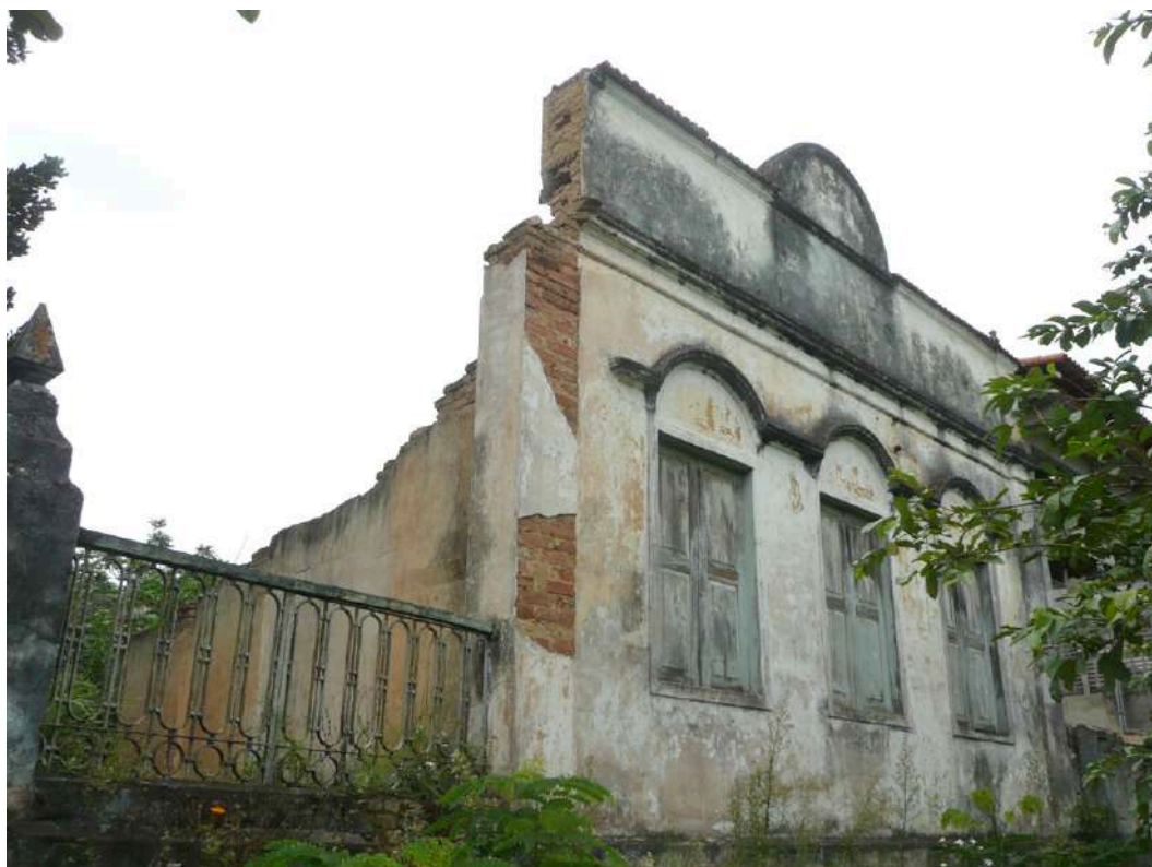
Figura 72: Mansões em decadência no Centro Velho de Itambi. Fonte: Arquivo próprio, 2011.
